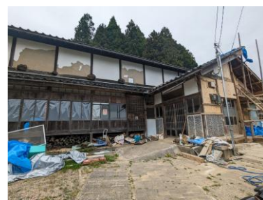
七尾市・被災した家屋
